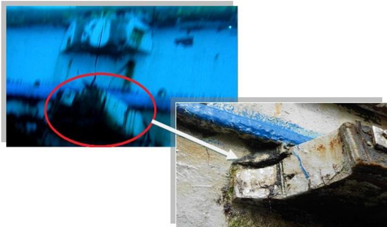
Εικόνα 8 : Οι ρωγμές στους πλευρικούς «τάκους» του σκάφους. (Πηγή: Λ/Χ Ρεθύμνου)
